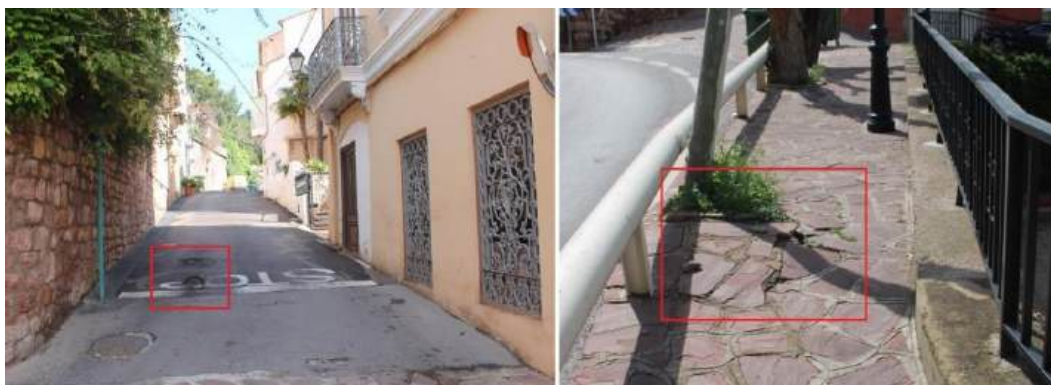
Exemple de calçada amb asfalt en mal estat i de vorera amb paviment alçat per l'arbratge.
